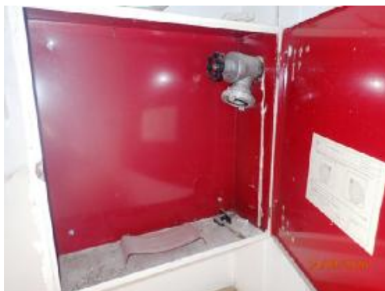
Požiarny hydrant bez výbroje
