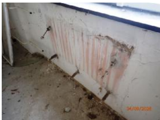
Chýbajúci radiátor v izolačke 205
