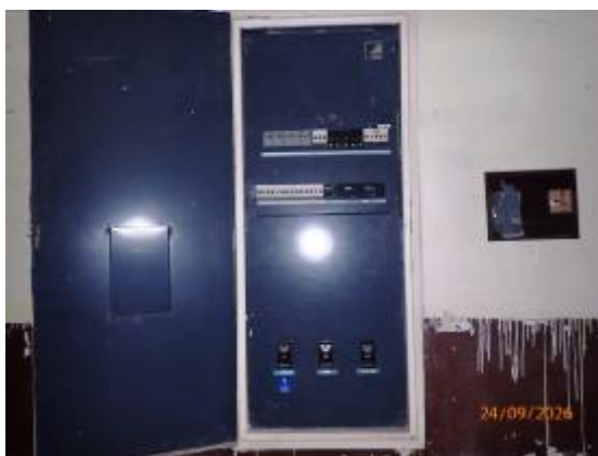
Rozvádzač v podbráni 201
