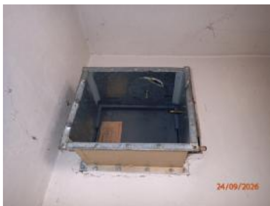
Zvyšok potrubia VZT v kuchyni
