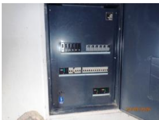
Rozvádzač na II.NP
