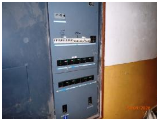
Rozvádzač ELI pre kuchyňu
