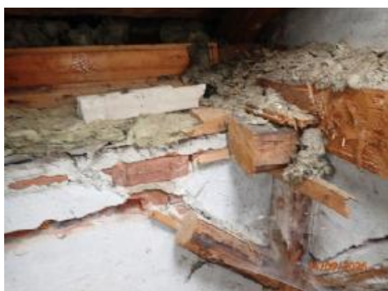
Chýbajúce prvky krovu
