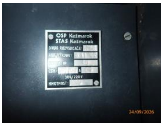
Štítok rozvádzača, r.v. 1987
