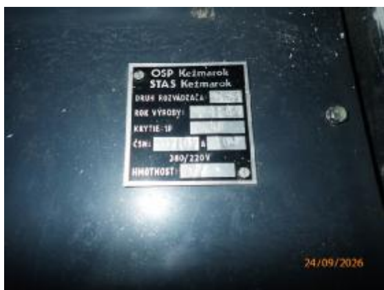
Štítok rozvádzača, r.v. 1987
