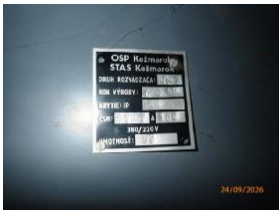
Štítok rozvádzača, r.v. 1988
